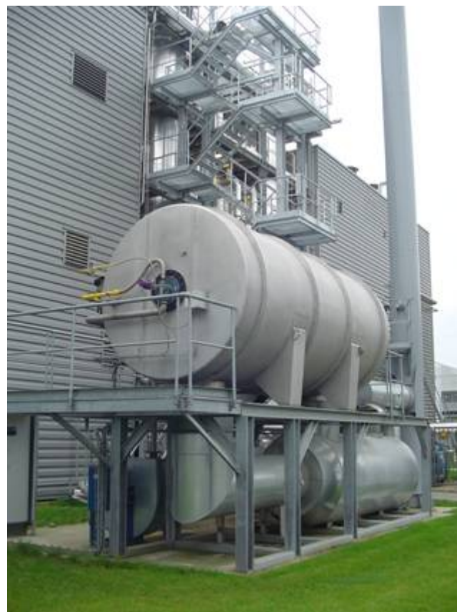
Oxydeur thermique des gaz (RTO)
