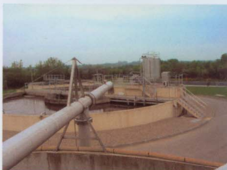
Station d'épuration : pour rendre l'eau apte à l'arrosage du golf, un dispositif de traitement tertiaire a été installé : filtres à sable et ultraviolets. L'unité d'hygiénisation assure la conformité microbiologique de l'eau au rythme de 80 m 3 /h.
