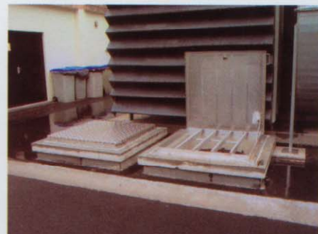
Piscine de Nantes ; bacs tampons permettant d'absorber les variations de volume.
